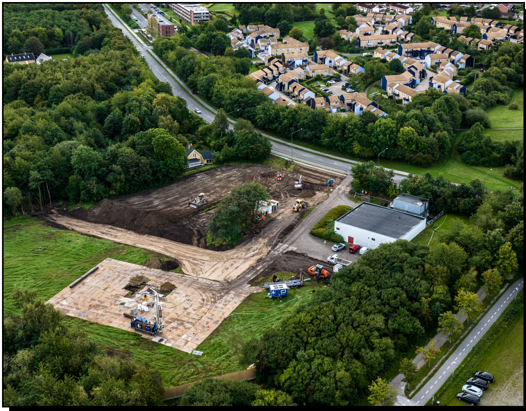
Figur 3 Dronefoto av anlegget før borerigg er satt opp (foto Kasper Hornbæk, Innargi)
